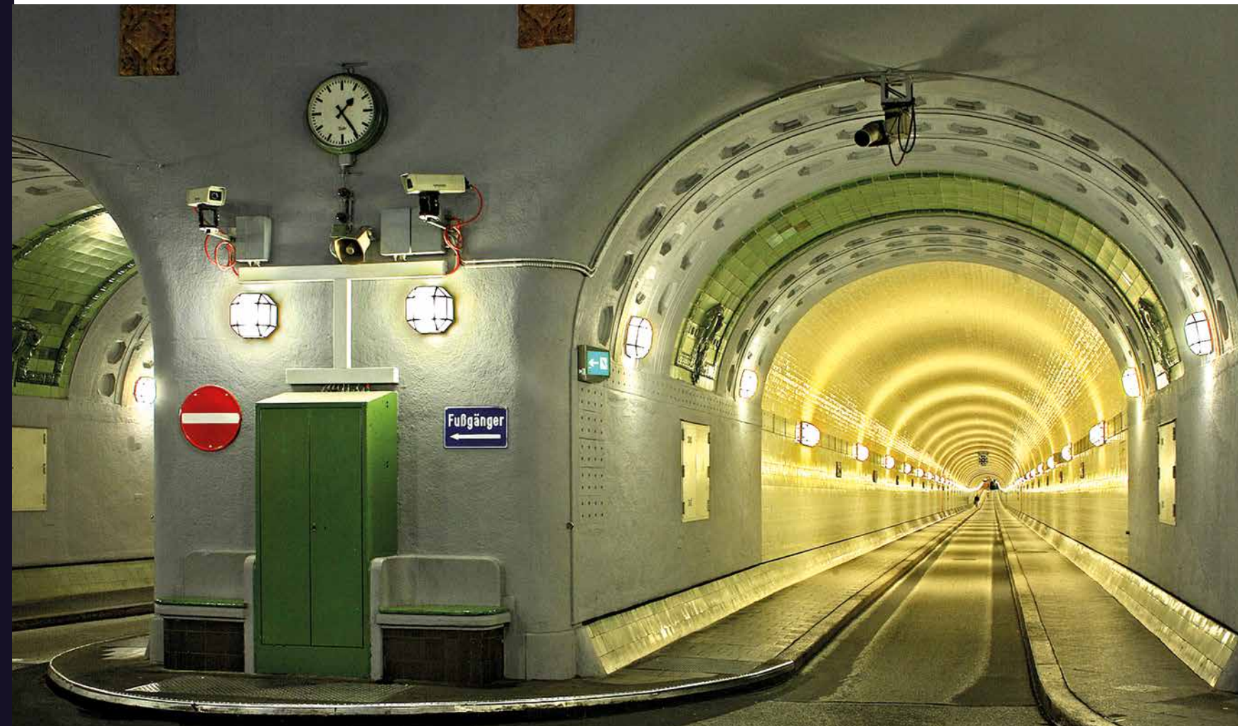
Wandleuchten als Einzelfertigung, alter Elbtunnel, Hamburg
